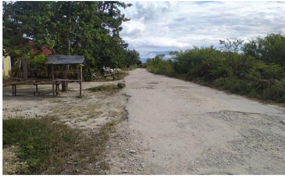
Gambar 4. Kondisi jalan menuju sekolah
